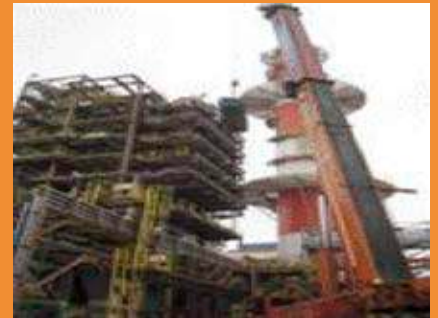
中龍-精煉爐集塵系統工程
