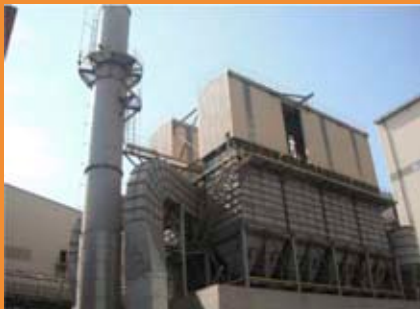
精煉爐集塵器外觀照
