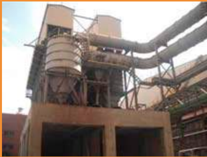
精煉爐集塵器外觀照
