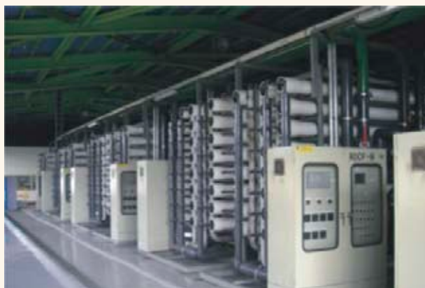
中鋼工業廢水回收純化場內部
